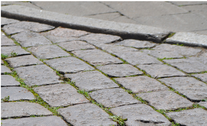
Im März des kommenden Jahres sollen die Sanierungsarbeiten der Fahrbahn und der Gehwege am Südufer des Pfaffenteichs starten. © LHS
