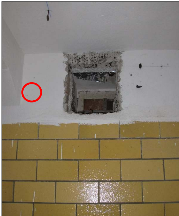
Abb. 2: Am 21.12.12 konnte eine Zwergfledermaus und ein Skelett (vermutlich der gleichen Art) tief in der Wand vorgefunden werden (Lage - roter Kreis). Die Bauweise deutet darauf hin, dass der Hohlraum (zwischen Rückwand und vorgeblendeter Wand) ggf. sehr weit hineinreichen kann.
