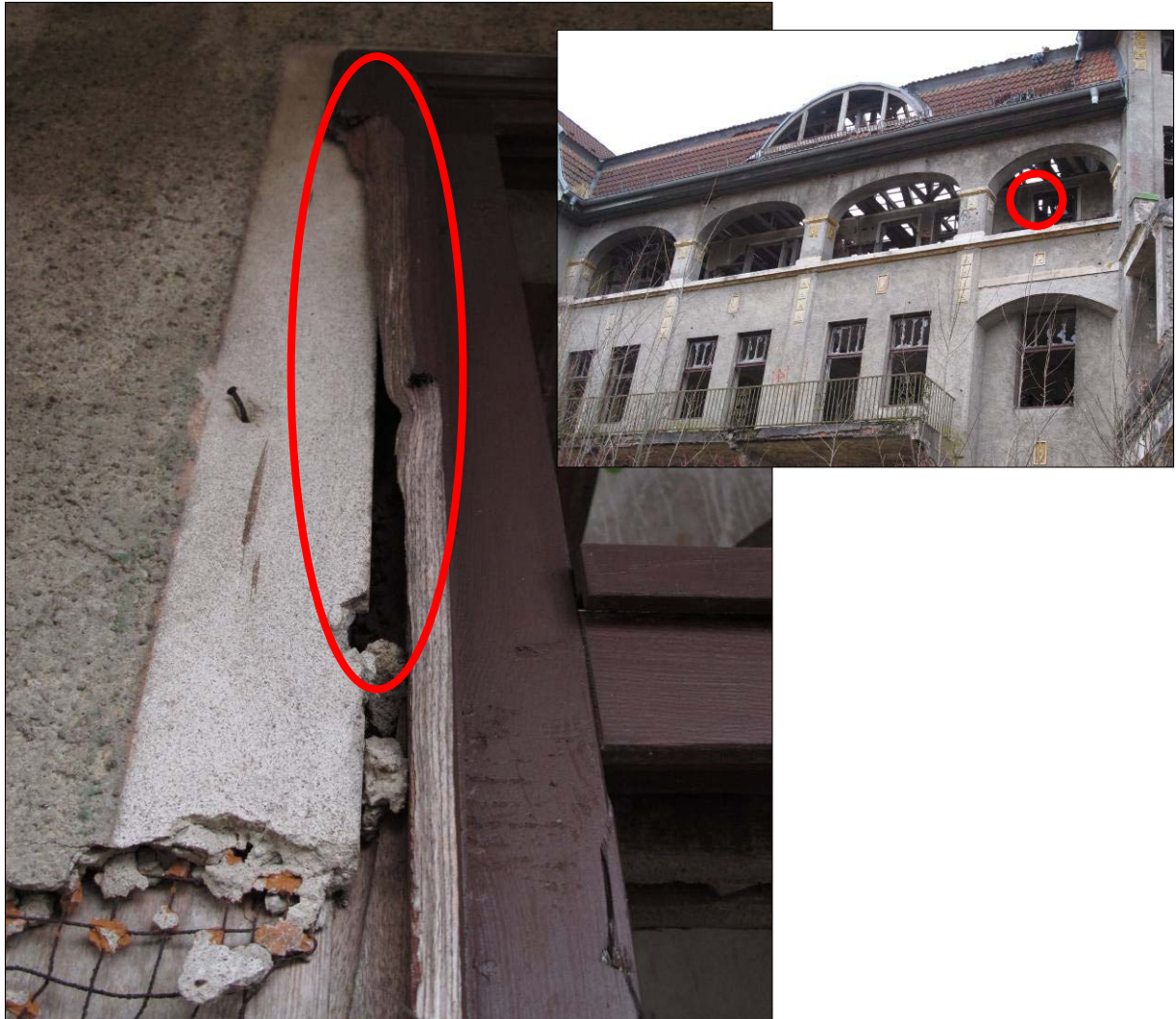
Abbildung 4: Sommer- / Zwischenquartier einer mittelgroßen Fledermausart (Kotfund) zwischen Fensterrahmen und Laibung auf der Südseite des Gebäudes (siehe roter Kreis).
