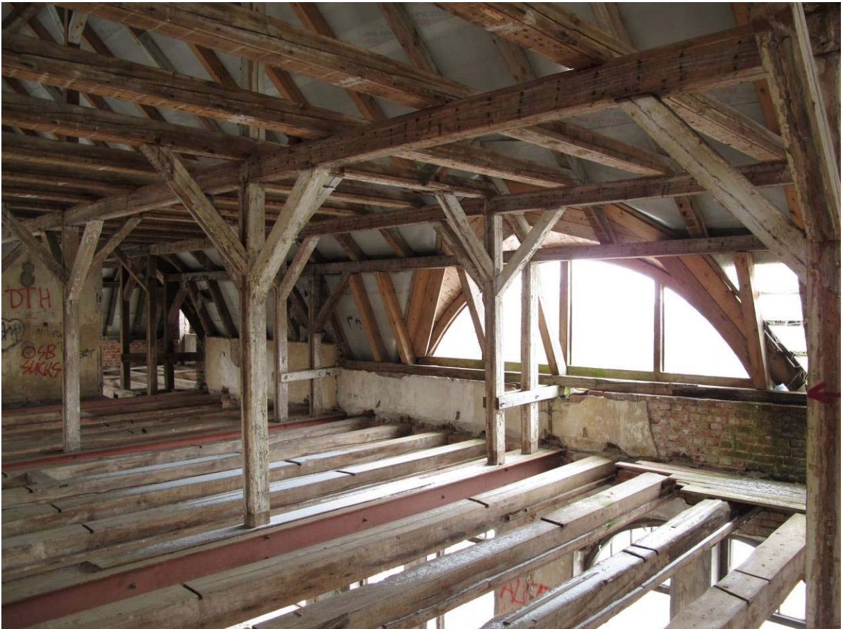
Abbildung 8: Der gesamte Dachraum bietet durch sein Volumen und die vorhandene Struktur eine Fülle an Quartiermöglichkeiten die von mehreren Arten - aber vermutlich nur von Einzeltieren oder kleinen Gruppen - genutzt werden können. Neben Zapflöchern und Balkenkehlen sind ebenso Hohlräume zwischen Balkenköpfen und Mauerwerk als Quartier nutzbar.
