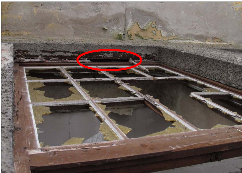
Abbildung 5: Durch das defekte Dehnungsband am oberen Fensterrahmen ergeben sich gute Einflugmöglichkeiten. Der darüberliegende Hohlraum ist u.a. für Wochenstubengesellschaft mehrerer Arten geeignet.
